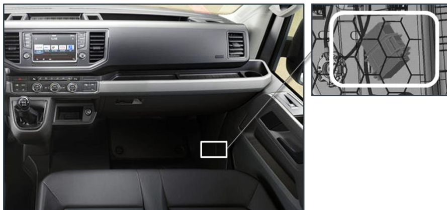
Morsettiera (IS1) dietro il rivestimento inferiore del montante A
