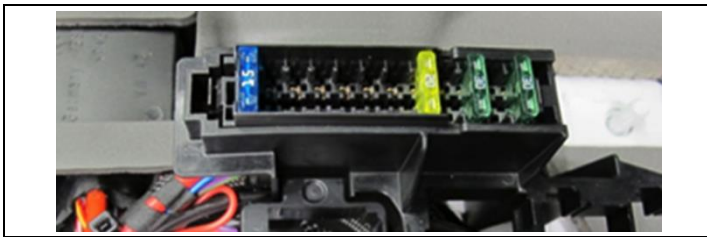
Dettaglio A: portafusibili - punto di prelievo per la seconda batteria
