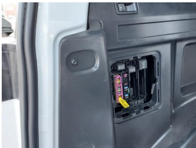
Abb. 1: Position des Sicherungsträgers im Laderaum links hinter der Verkleidung
