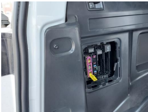
Fig. 1 : position du porte-fusibles dans l'espace de chargement à gauche derrière le revêtement
